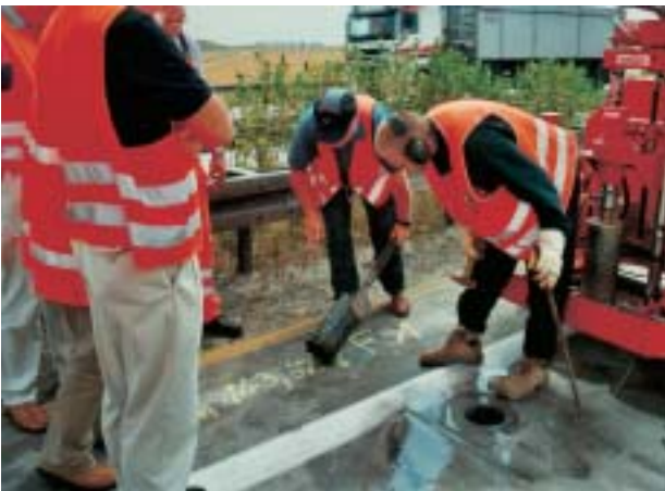
Abb. 2: Ziehen eines Bohrkerns aus geschädigter Betonfahrbahndecke zur Materialprüfung und Ursachenforschung.
