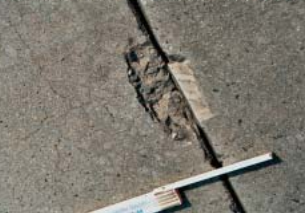
Abb. 1: Zuschlagbedingter physikalischer Betonschaden an einer Autobahn-Betonfahrbahndecke. Abplatzung im Fugenbereich in Folge von Netzkissen als Ergebnis von Treibreaktionen im Beton (AKR). Unter der starken Verkehrsbelastung führen die Netzkisse schlussendlich zur Zerstörung der Fahrbahndecke und anschließenden kostenintensiven Sanierungsmaßnahmen.
