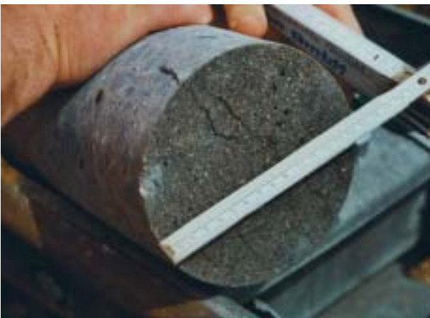
Abb. 3: Die deutlich erkennbaren, z.T. mehrere cm in den Bohrkern hinein reichenden Risse zeigen, dass der Beton nicht nur an der Oberfläche geschädigt ist.
