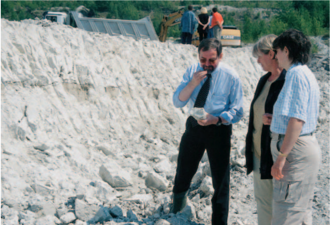
Abb. 1: Gewinnung weißbrennender eozäner Tone bei Roßbach westlich Merseburg. Die außerordentlich hohe Qualität dieser Lagerstätte ermöglicht über die Grenzen Deutschlands hinaus einen breiten Einsatz dieses gesuchten Rohstoffs in der keramischen Industrie.
