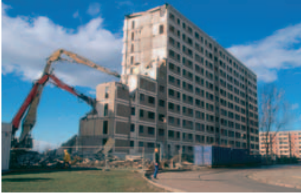
Abb. 9: Abriss eines Plattenbau-Wohnblocks in Halle Silberhöhe im Februar 2002. In diesem Wohngebiet führt der hohe strukturelle Leerstand zum Abbruch großer Komplexe mit einem erheblichen Anfall von rezyklierbarem Betonbruch (Foto: S. MÜLLER, Institut für Geowissenschaften, MLU Halle).
