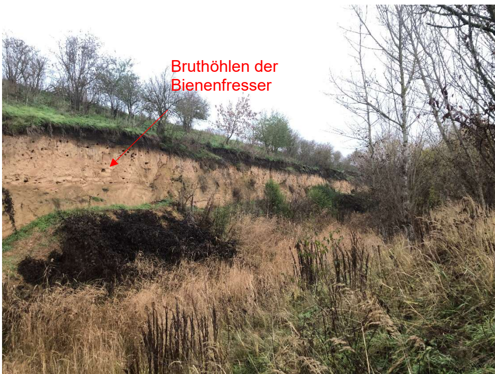
Abbildung 4: Aktueller Zustand der westl. Böschung und des Einschnittes
