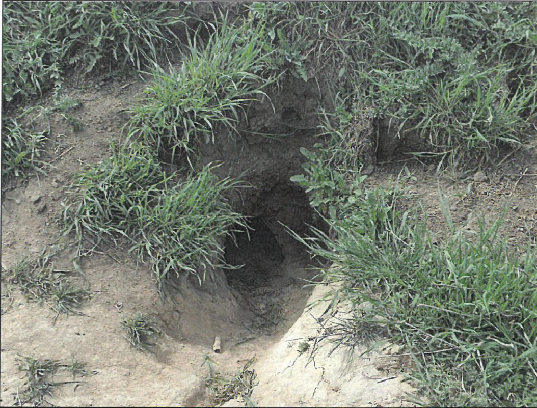
Abb. 4: Fuchsbau im Böschungsbereich nördlich des Tagebaus.
